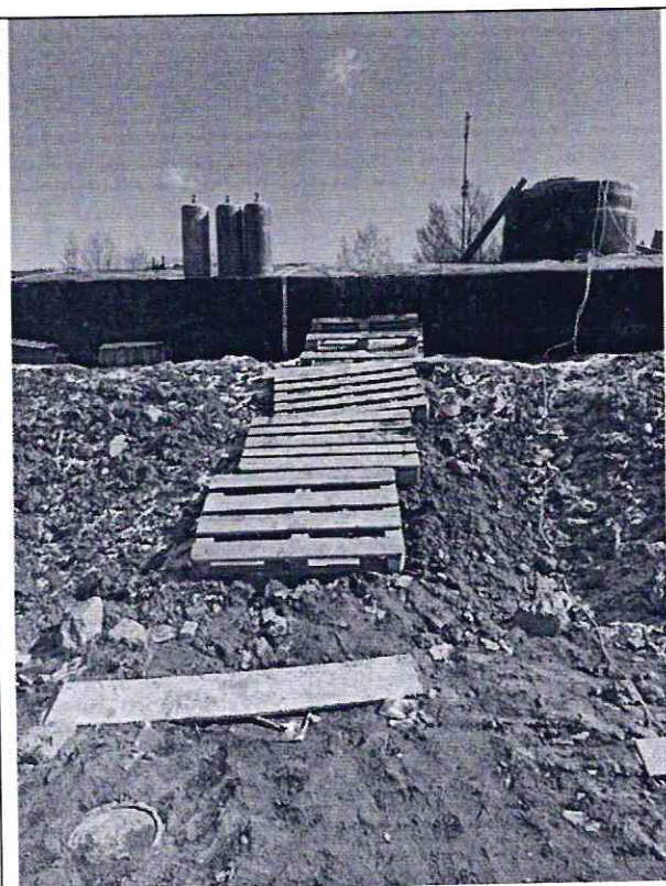
Рис. 16. Отсутствует лестница для подъема на РЧВ.
