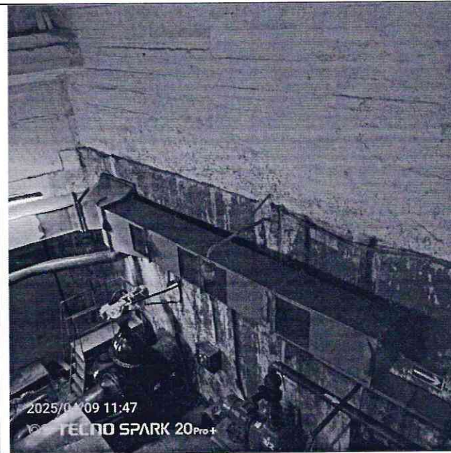
Рис.27. Требуется окраска стен в машинном помещении
